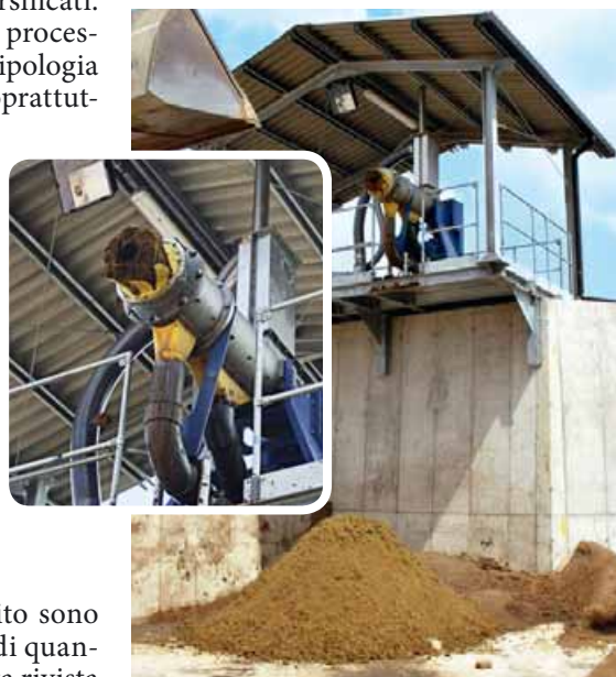
Impianto di separazione completo.
