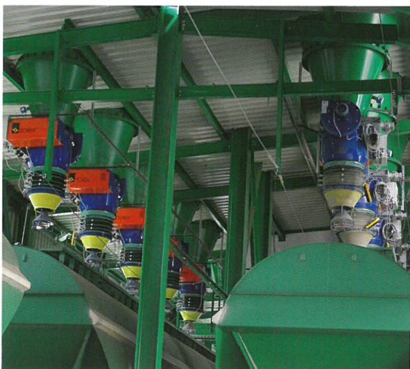
Abb. 1: Siloanlage mit Torex-„Bellojet“ zur Verladung in geschlossenen Eisenbahnwaggons
